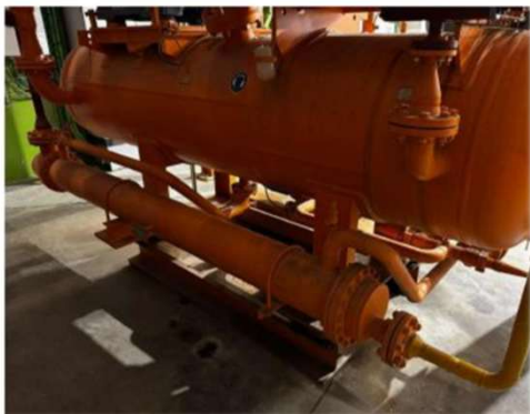
2. Compresores varios sin recuperadores
